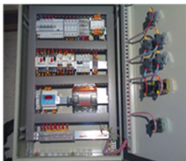
Armoire de contrôle / commande
